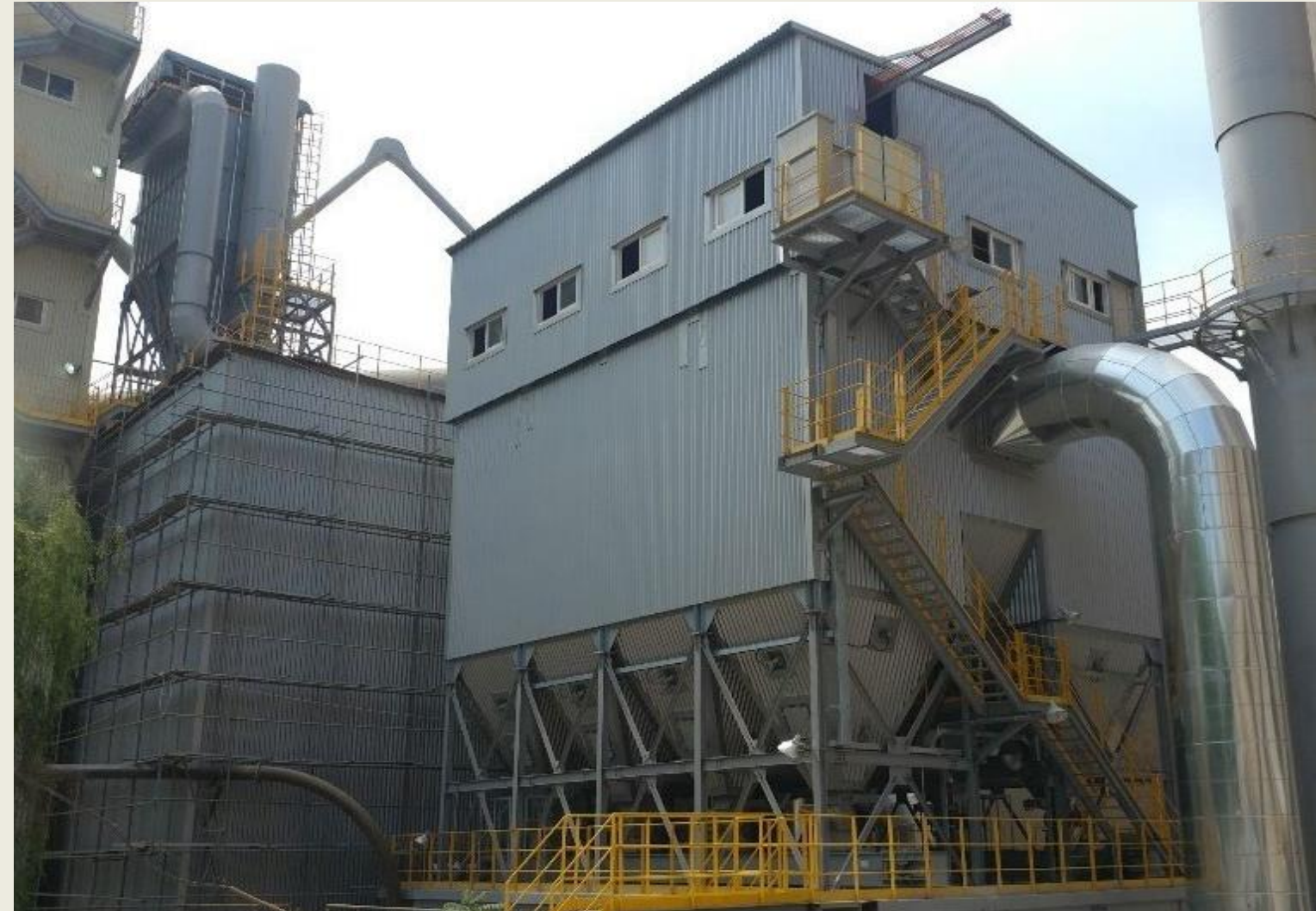
한일현대시멘트(주) 단양공장 건식모래 집진설비 제작설치(120,000m 3 /hr 外)
